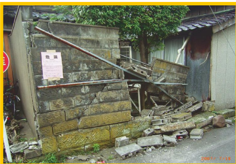
地震により倒壊したブロック塀などの例
