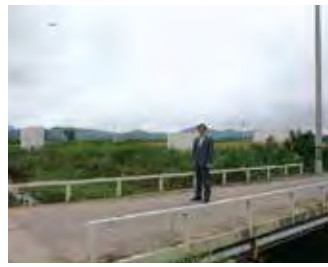
▲写真①:現在の住社橋の上流部で架け替え工事が進行中です。
