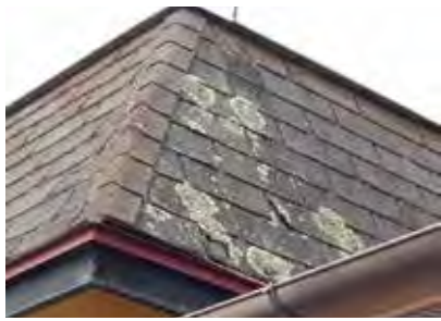
▲老朽化で傷みが目立つ角田保育所
