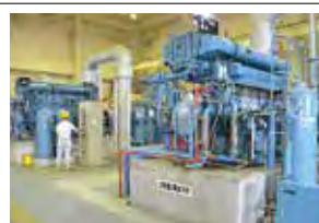
▲4台ある排水ポンプ
