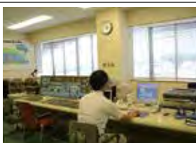
▲川の水の状況を見てポンプを稼働させます。
