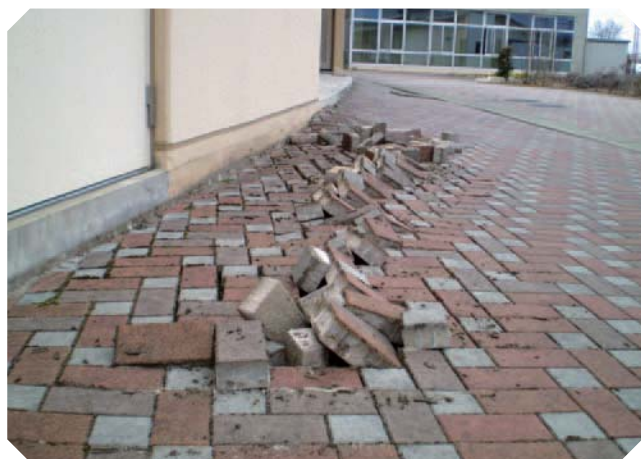
めくりあがったインターロッキング（ウエルパーク）
