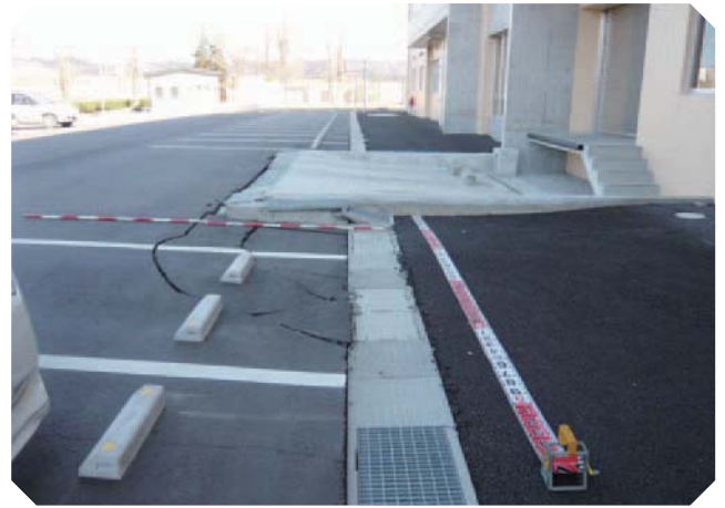
亀裂の入った駐車場（北角田中学校）
