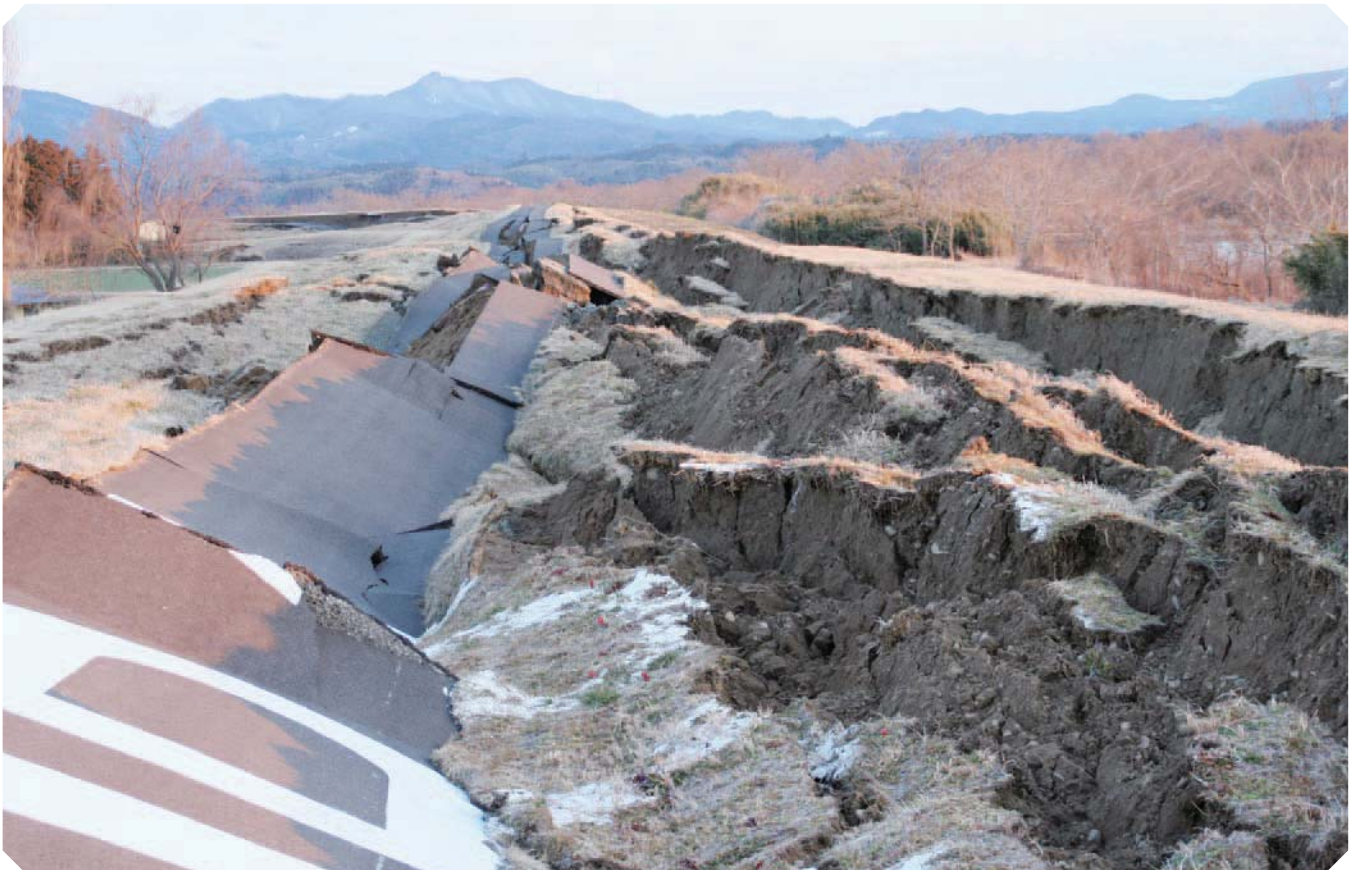
崩落した阿武隈川堤防（枝野5区行政区）
