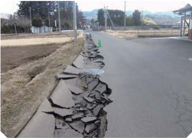
一部損壊した道路（藤尾3区行政区）
