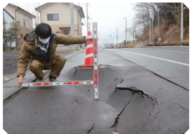
隆起したマンホールの測量（北岡行政区）
