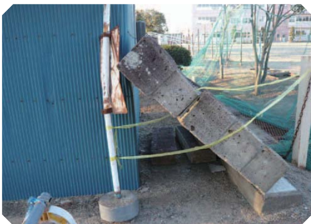
倒壊した塀（金津中学校）
