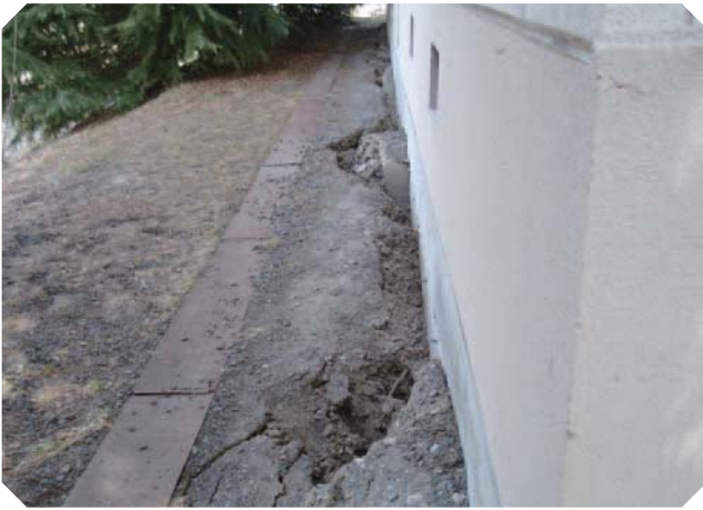
亀裂の入った地面（東根小学校）
