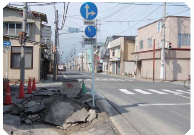
隆起した下水道マンホール（西仲町行政区）
