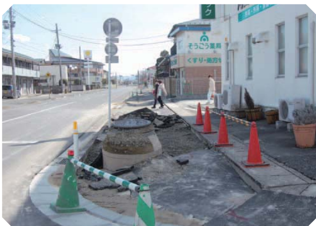
隆起したマンホール（西仲町行政区）
