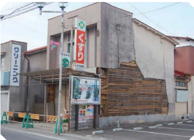
一部損壊した建物（天神町行政区）
