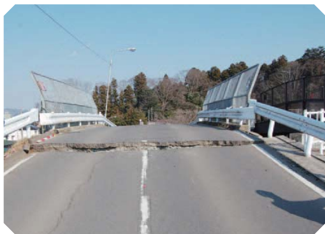
亀裂の入った跨線橋（老ヶ崎行政区）
