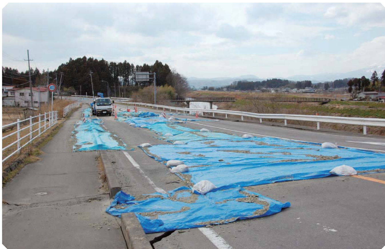
亀裂が入り通行止めとなった国道349号（北江尻行政区）
