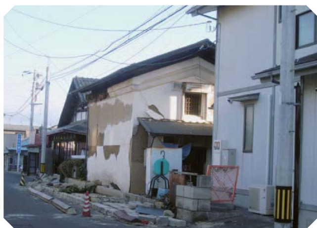
土壁が崩落した蔵（東仲町行政区）
