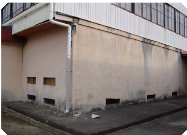
一部損壊した体育館（北角田中学校）
