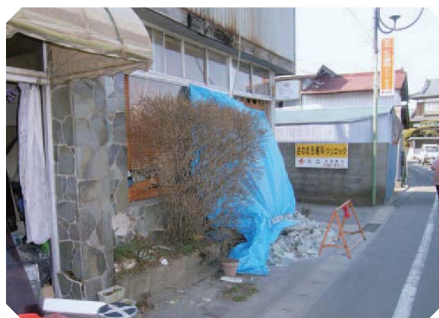
1階の壁が崩落、窓が破損（西田町行政区）
