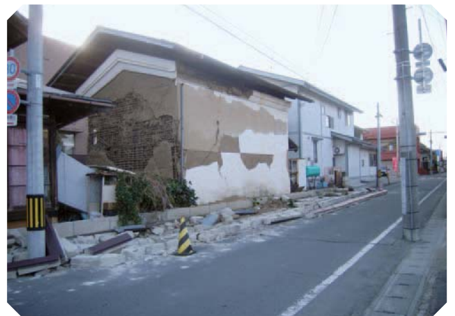
壁が崩落した倉庫（東仲町行政区）
