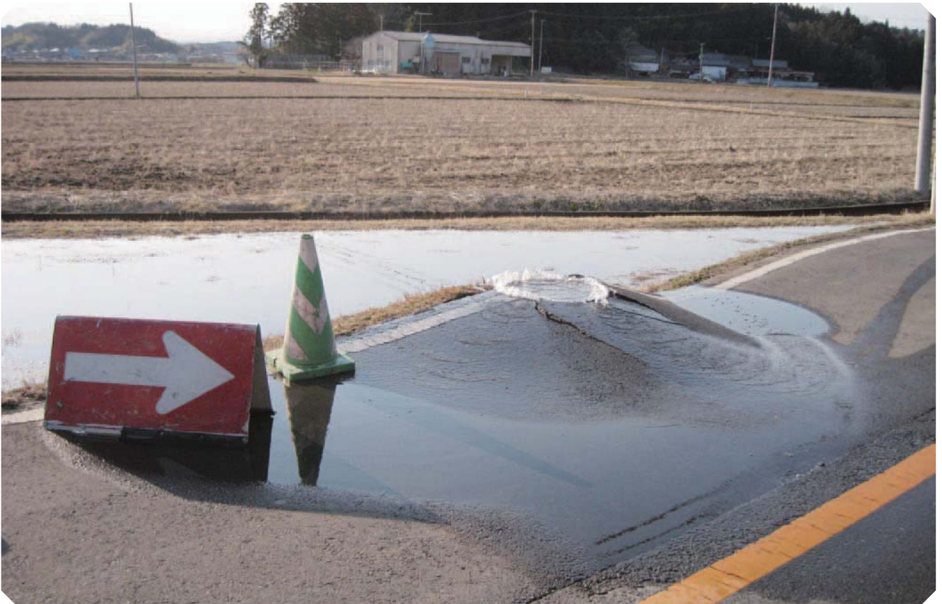
下水マンホールからあふれる汚水（北江尻行政区）
