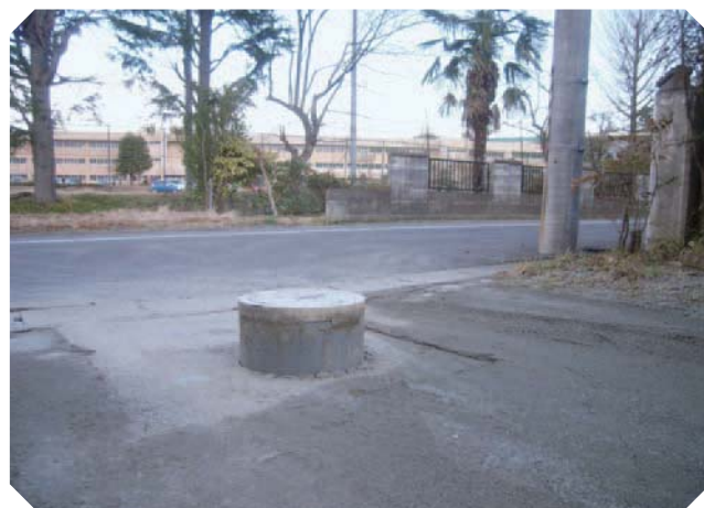
隆起したマンホール（北町行政区）
