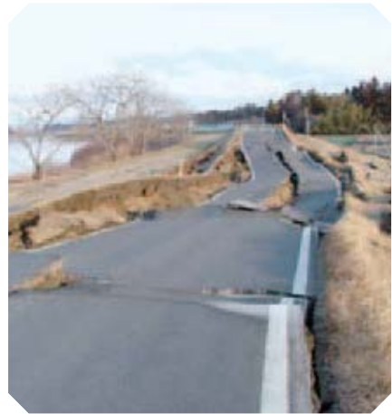
崩落した阿武隈川堤防（坂津田中行政区）（提供：仙台河川国道事務所）
