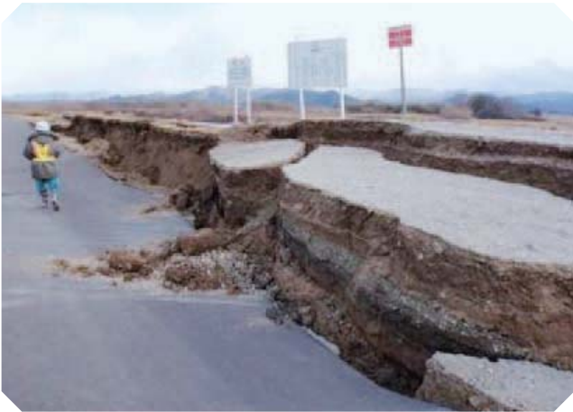
崩落した阿武隈川堤防（枝野5区行政区）（提供：仙台河川国道事務所）
