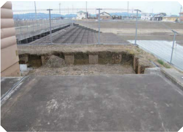
陥没した貯水池地内の管理棟敷地（町尻地内）
