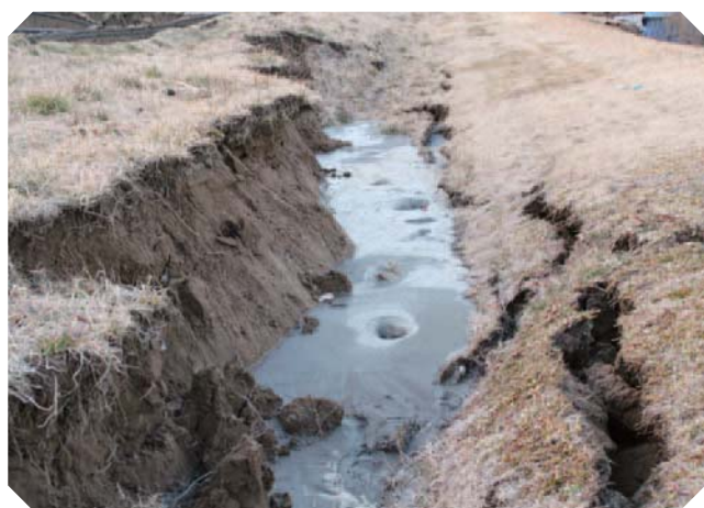
阿武隈川堤防の液状化現象（野田行政区）
