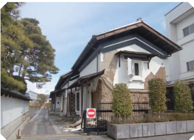
壁が一部損壊した郷土資料館
