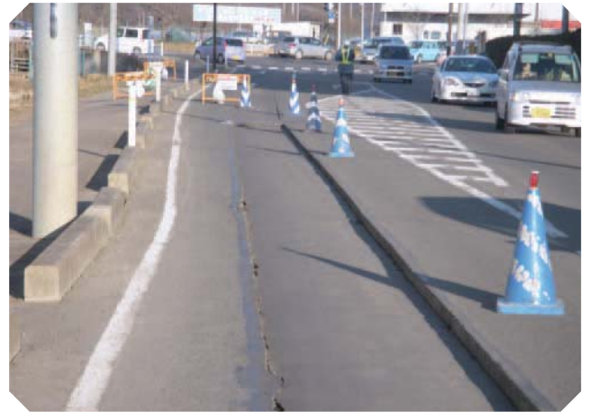
道路の一部損壊（南江尻行政区）
