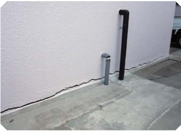
一部損壊した校舎（桜小学校）
