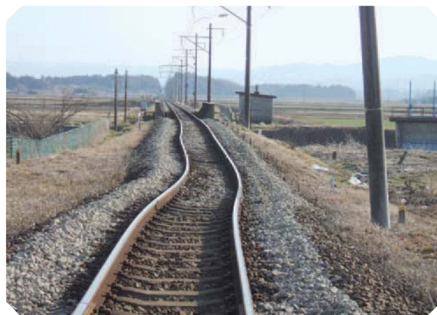
地震によりゆがんだ線路（岡駅～横倉駅間）
