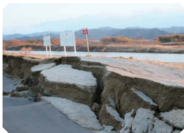
崩壊した阿武隈川堤防（野田行政区）
