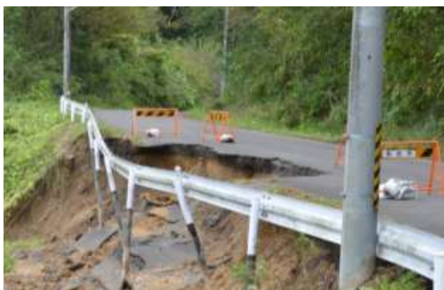
通行止めの状況
