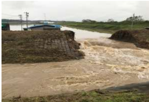
庄司堀川左岸堤防破堤
