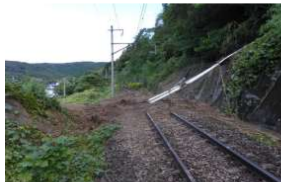
沿線の土砂崩れ
