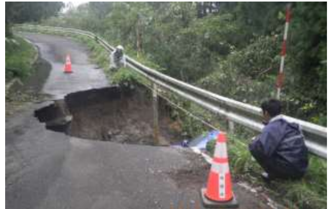
農林業施設の被害状況
