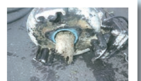
▲下水道が詰まっている様子
