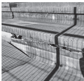
▲スタンドの亀裂
