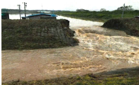
庄司堀川左岸堤防破堤
