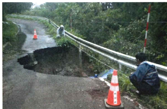
農林業施設の被害状況
