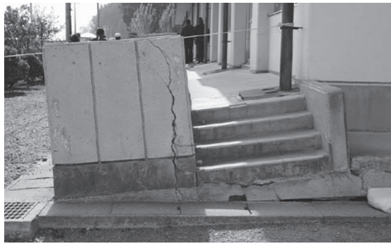
▲地盤沈下した北郷小学校テラス
