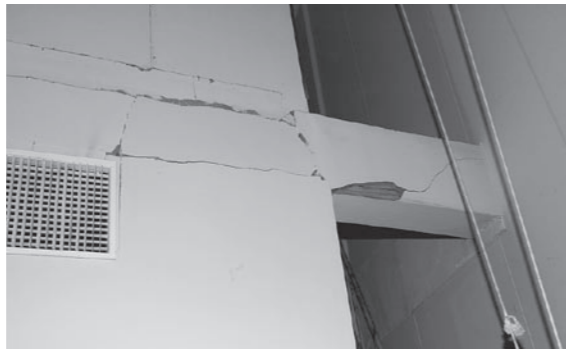
▲ヒビ割れした市民センター大ホール
