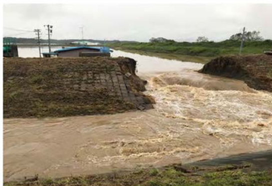
庄司堀川左岸堤防破堤
