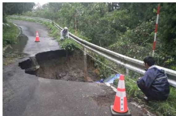
農林業施設の被害状況
