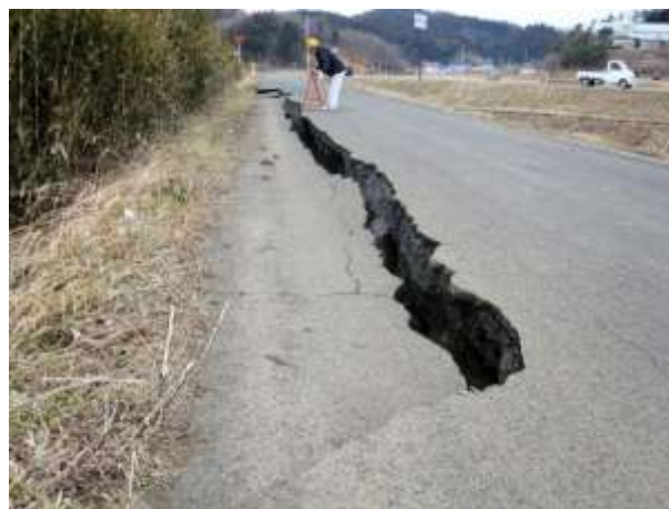
▲道路のいたるところに亀裂や段差（梁瀬）
