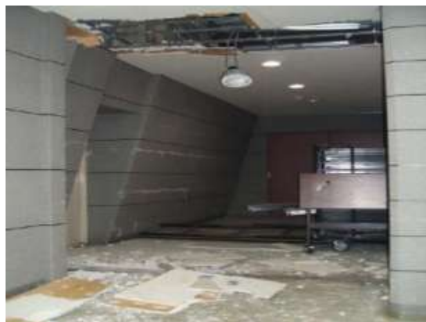
▲市民センター大ホール通路の天井が落下
