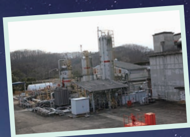
▶液体酸素/液体水素供給系試験設備
