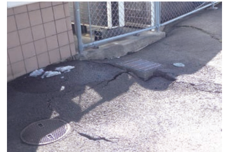
④▲角田駅ホーム構内亀裂
