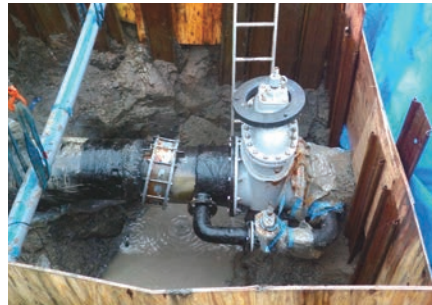
③▲左関地内水道管破裂
