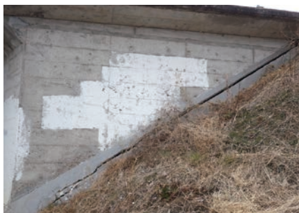
⑤▲阿武隈急行線笠島川架道橋亀裂
