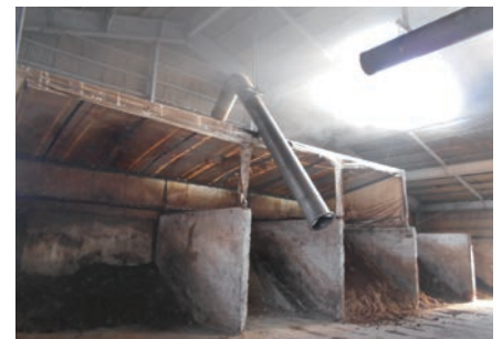
①▲農業の館脱臭管破損
