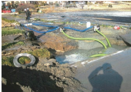
②▲左関地内水道管破裂
