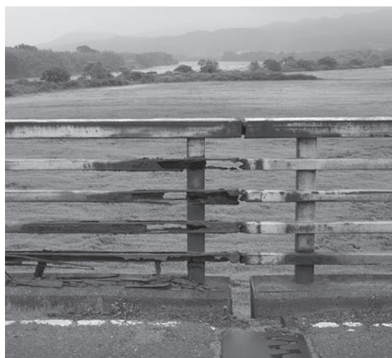
▲腐食損傷が激しい東根橋の車道の防護柵
