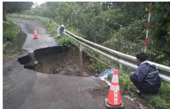
農林業施設の被害状況
