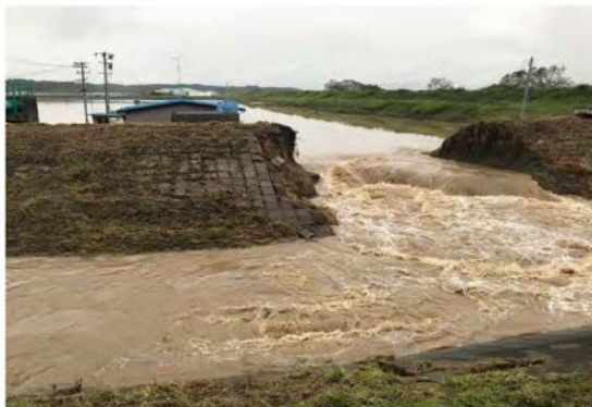
庄司堀川左岸堤防破堤
